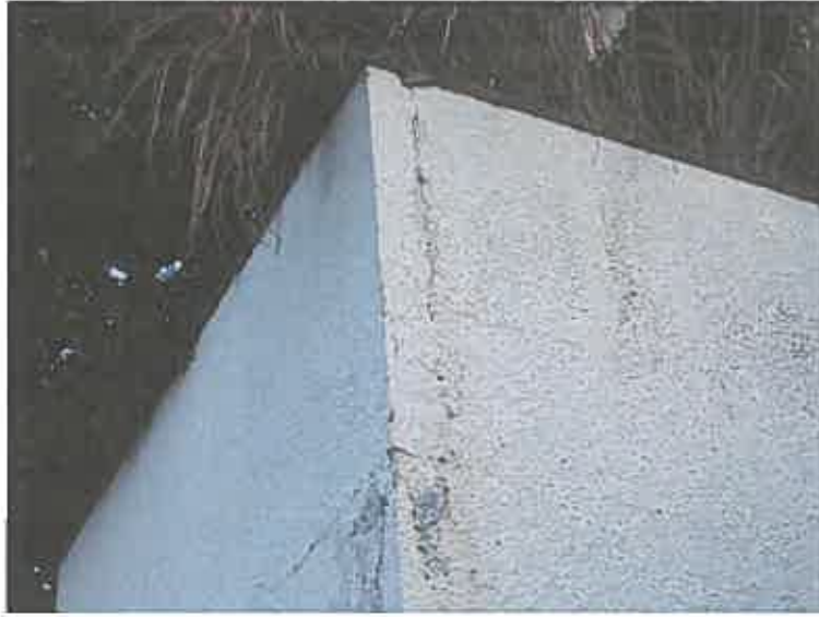
写真4 コンクリート塀のクラック
