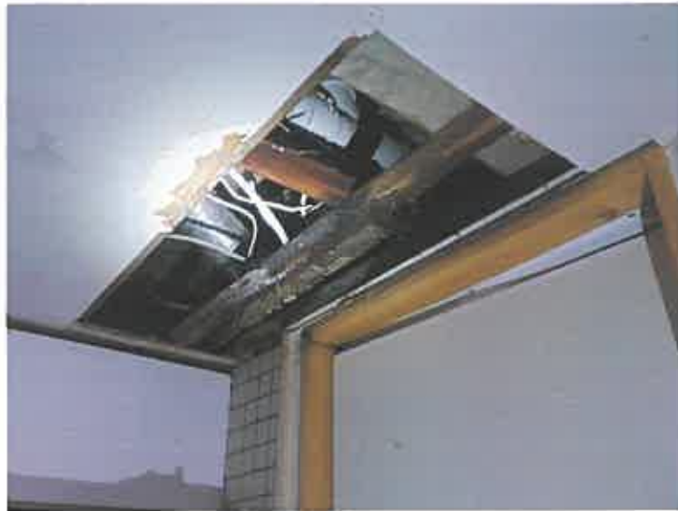
写真17 202号室 (水漏れ箇所)
