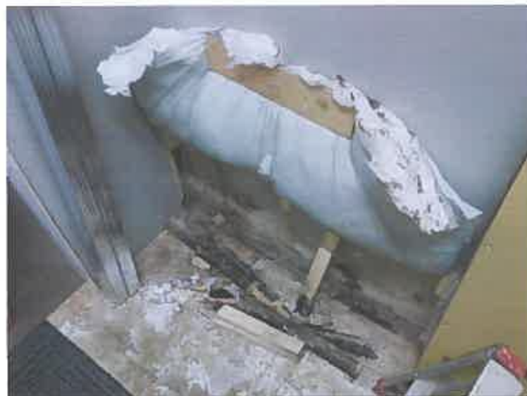
写真9 101号室 (水漏れ箇所)
