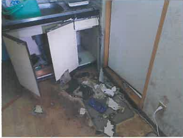
写真16 202号室 (水漏れ箇所)
