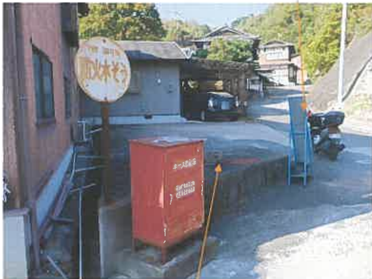
消防用防火水槽
