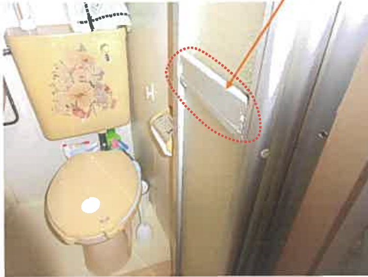
写真14 (本件建物 2階 (203号室)) 取っ手部分が外れている
