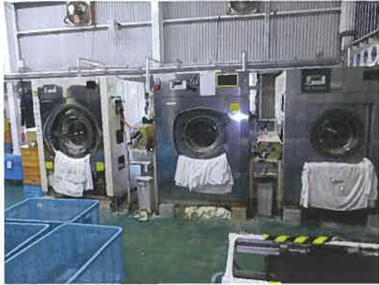
写真28(本件建物1階にある洗濯機)
