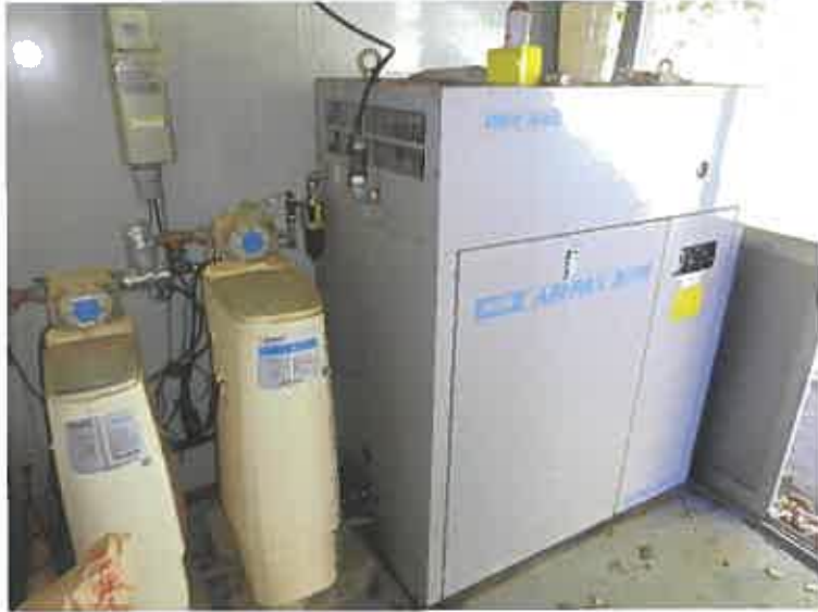
写真49(工作物①(倉庫)内にあるエアコンプレッサー等)
