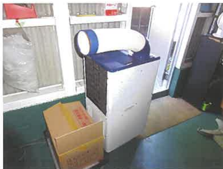
写真39(本件建物1階にあるスポットエアコン)
