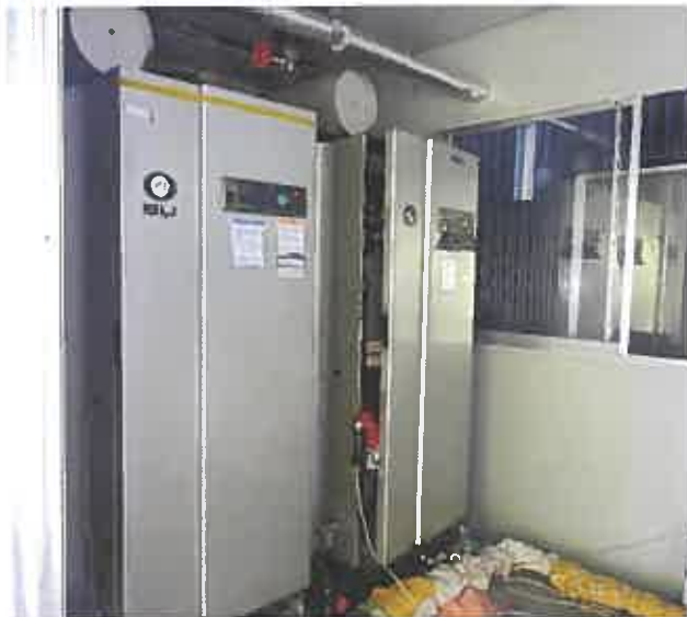
写真50(工作物①(倉庫)内にあるボイラー等)
