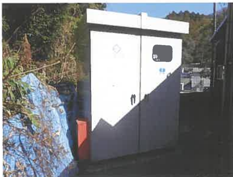
写真4 8(工作物 (変電設備))
