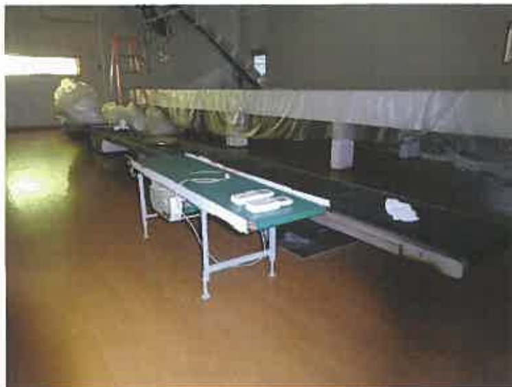
写真4 6(本件建物2階にあるベルトコンベア等)
