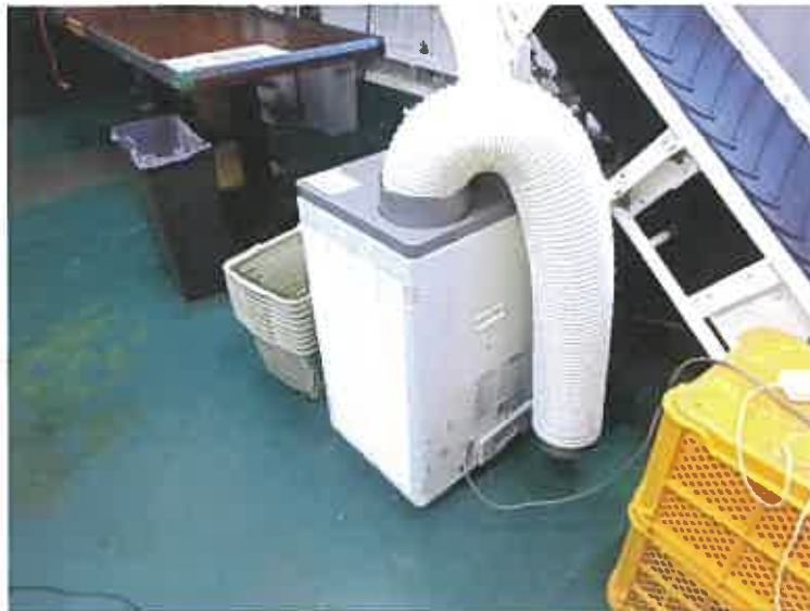
写真37(本件建物1階にあるスポットクーラー)
