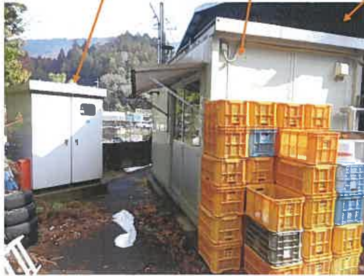
写真7 工作物 (変電設備) 工作物① 本件建物
