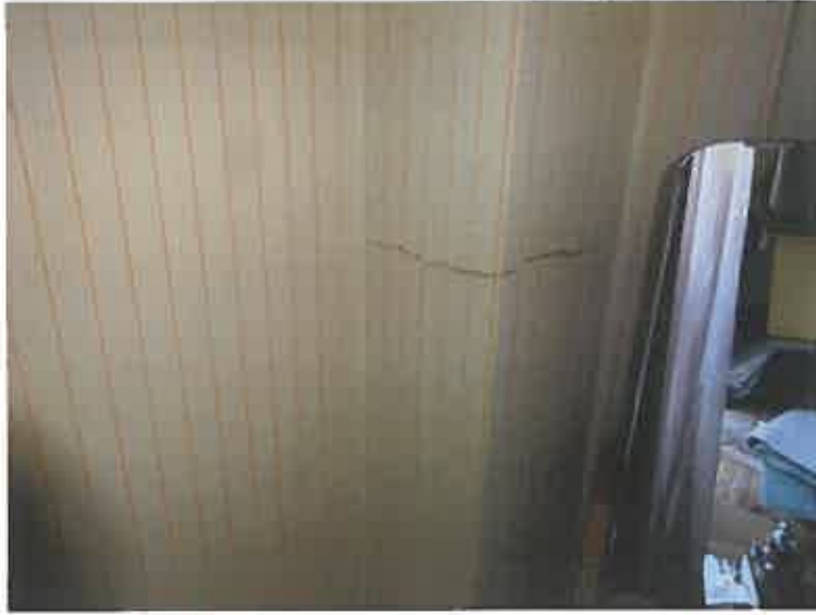
写真13 (本件建物 3階 (写真12のクラックを撮影))
