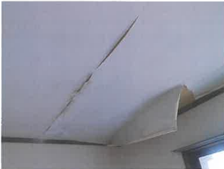
写真17 天井クロスの剥離
