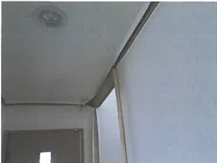
写真15 天井クロスの剥離
