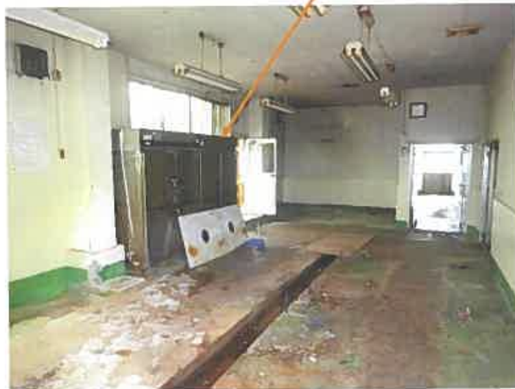
写真18 (本件建物 1階) 冷蔵庫
