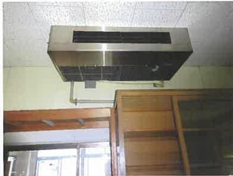
写真47 (本件建物内にある写真12のエアコン室内機)
