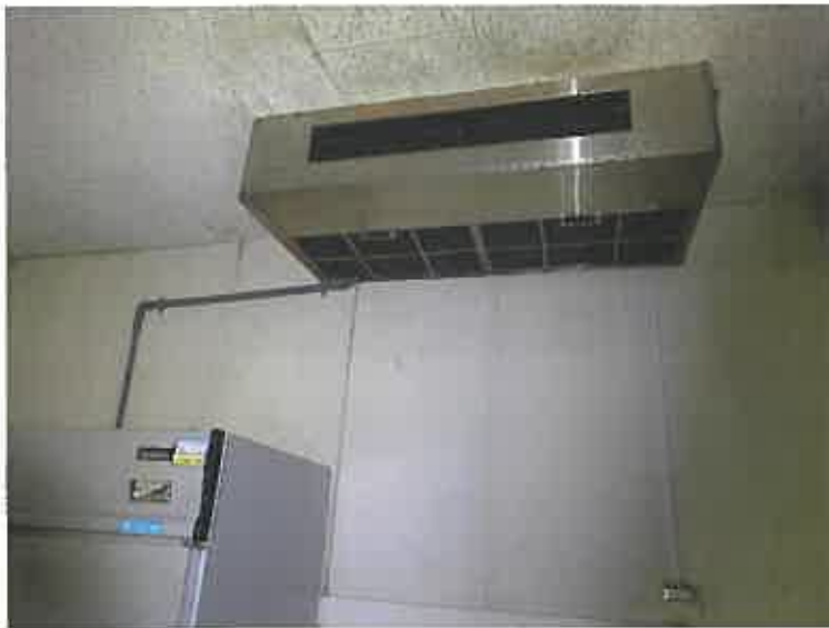
写真46 (本件建物内にある写真11のエアコン室内機)
