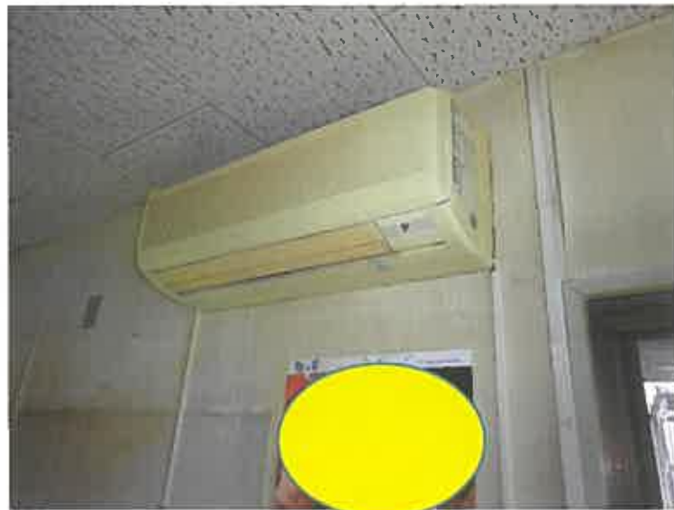
写真42 (本件建物内にある写真8のエアコン室内機)
