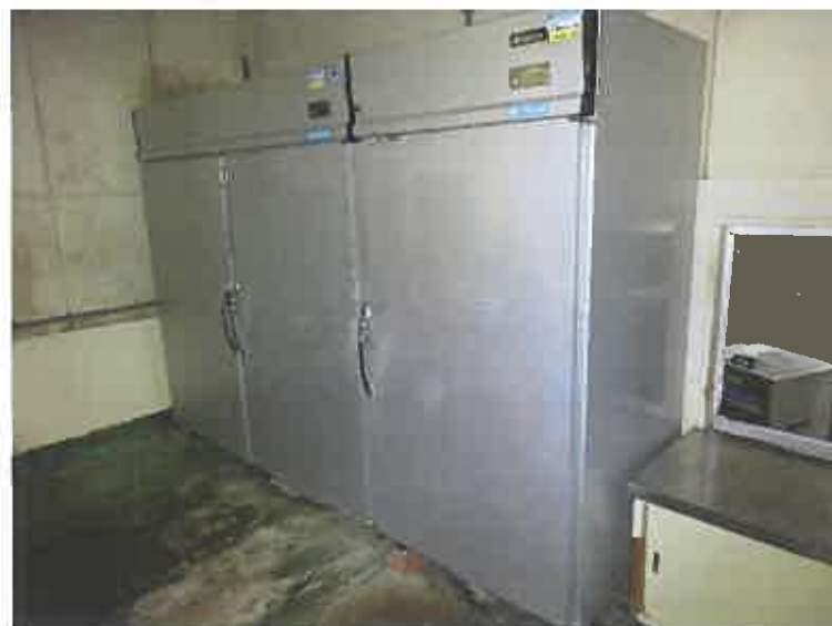
写真45 (本件建物内にある写真11の冷蔵庫)
