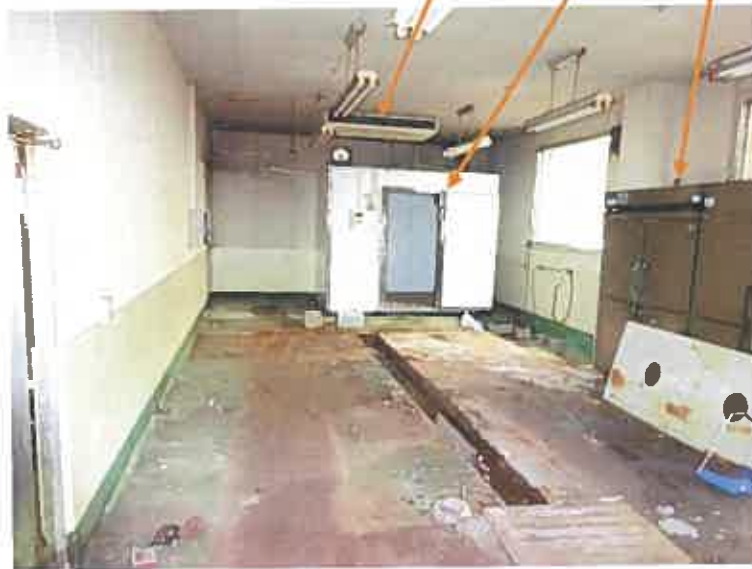
写真17 (本件建物 1階) エアコン 冷蔵庫 冷蔵庫
