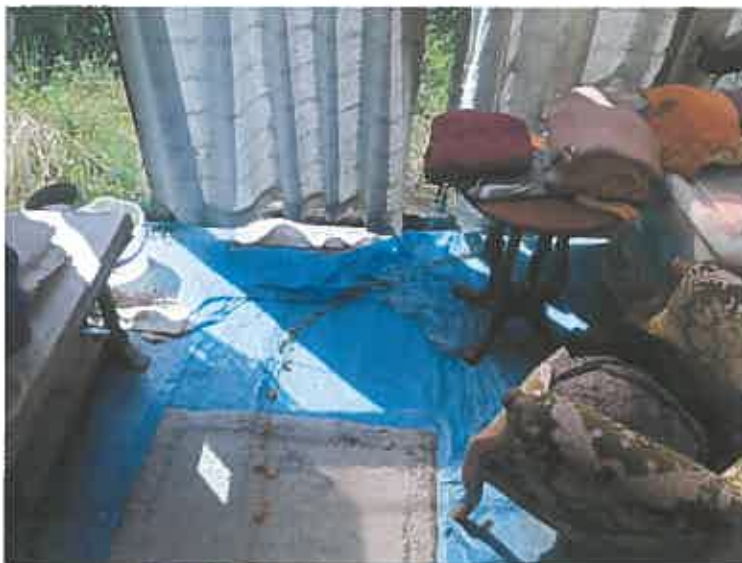
写真11 未登記増築部分（サンルーム）
