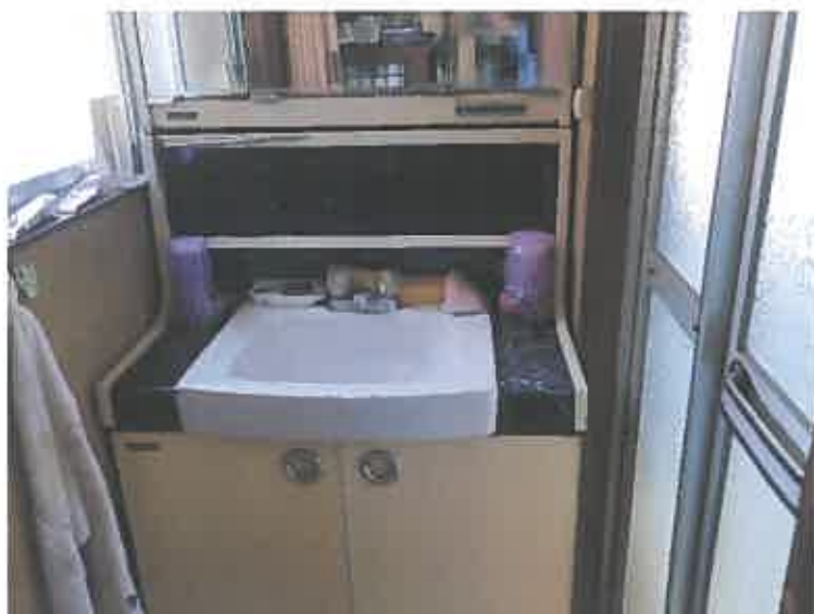
写真12 未登記増築部分（洗面所）
