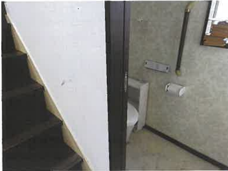
写真11 (本件建物 1階 (壁紙に落書きがある状況))
