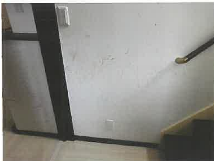
写真12 (本件建物 1階 (壁紙に落書きがある状況))
