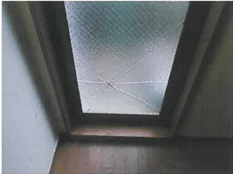
写真11 勝手口扉のガラス
