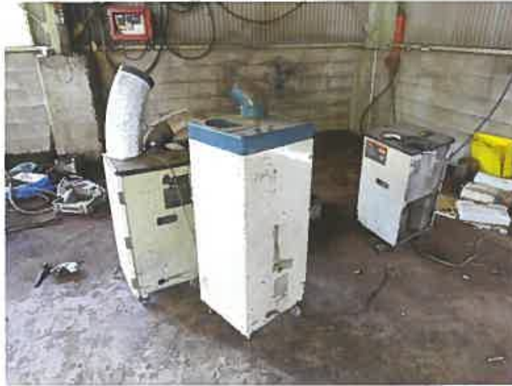
写真19 (本件建物内にあるスポットエアコン等)
