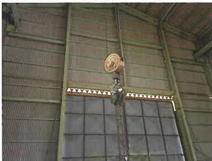
写真 1 4 (本件建物内 南側付近にある天井クレーン)
