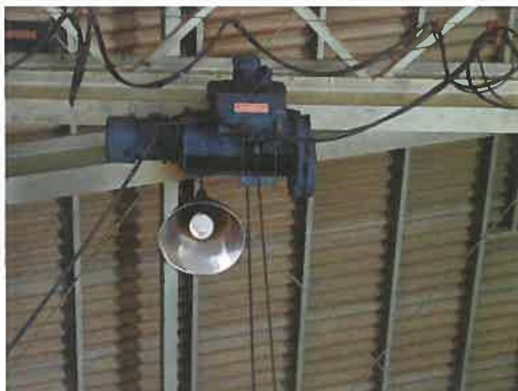
写真 1 5 (本件建物内 南側付近にある天井クレーン)
