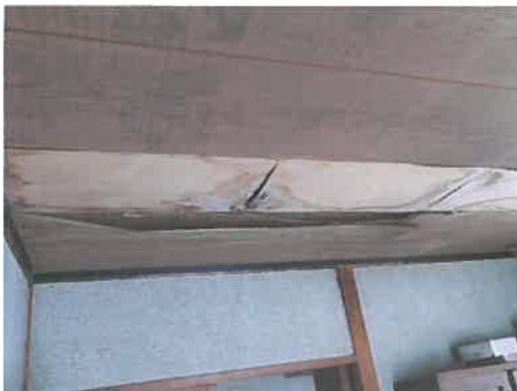
写真18 水漏れの痕跡
