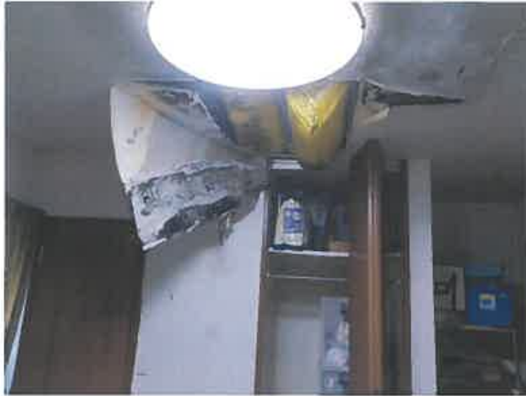
写真16 天井材等の破れ
