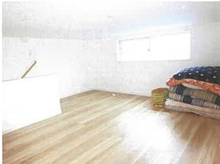
写真15 (本件建物 2階上の小屋裏物入れ内)
