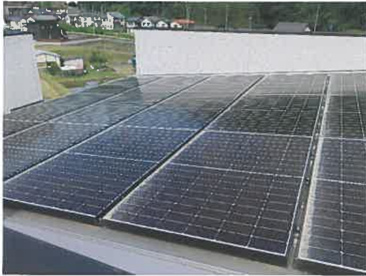
写真２２ 太陽光発電設備（ソーラーパネル）
