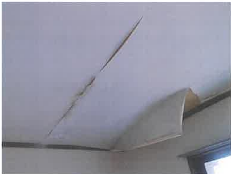
写真17 天井クロスの剥離
