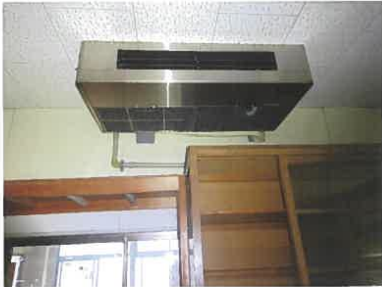
写真４７（本件建物内にある写真１２のエアコン室内機）
