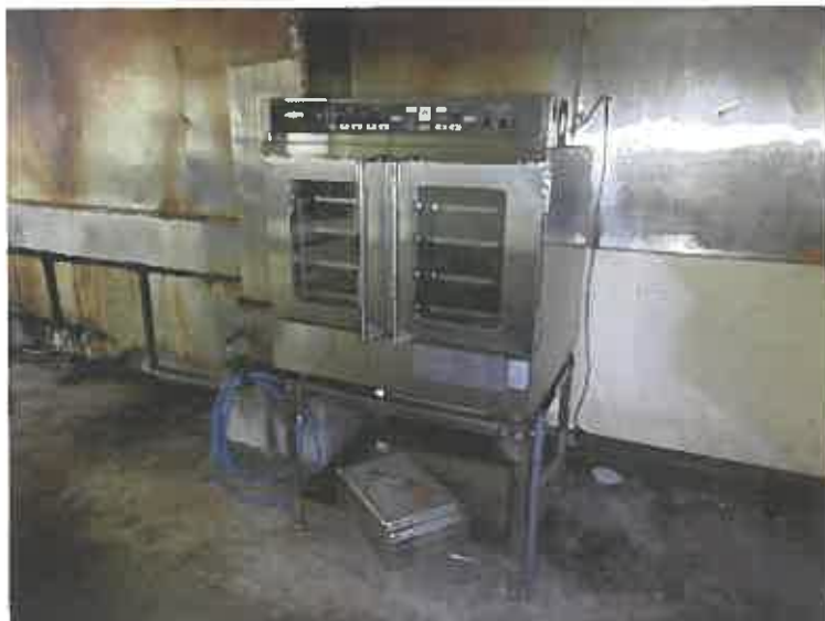
写真４８（本件建物内にある写真１５のオーブン）
