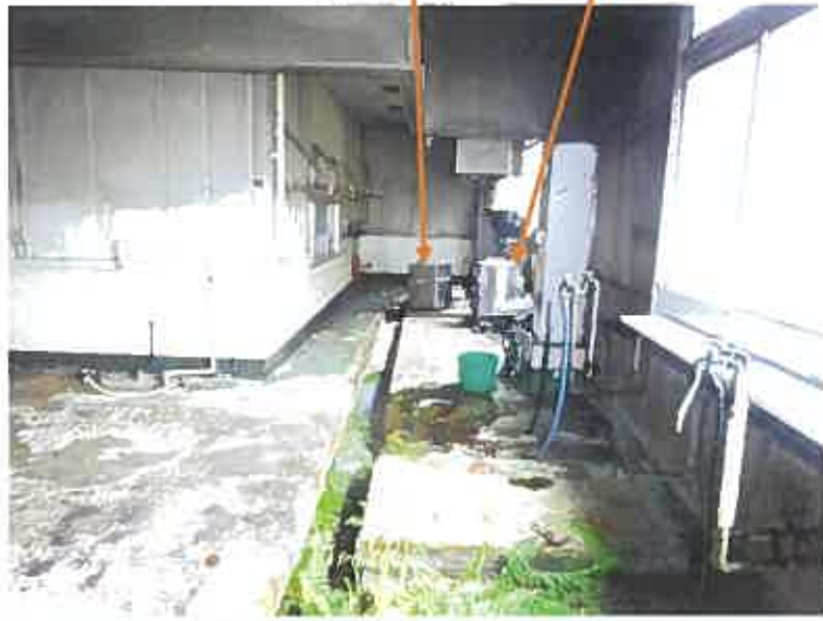
写真16 (本件建物 1階) 盛付器 洗米機
