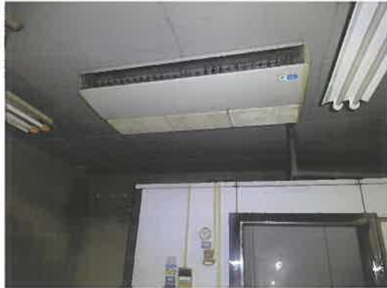
写真 5 3 (本件建物内にある写真 1 7 のエアコン室内機)
