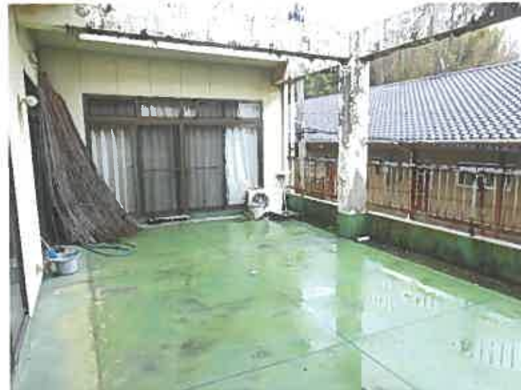
写真3 6 (本件建物 2階ベランダ)
