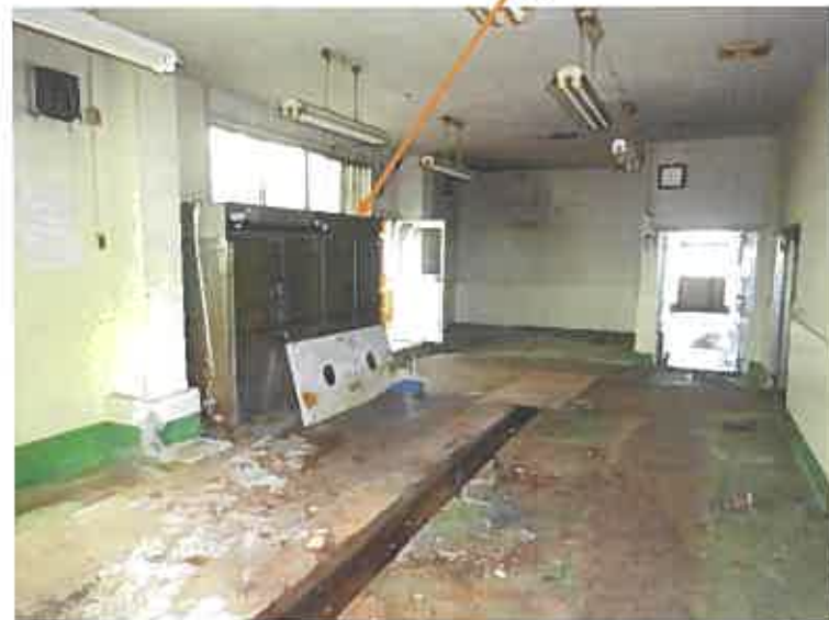
写真18 (本件建物 1階) 冷蔵庫
