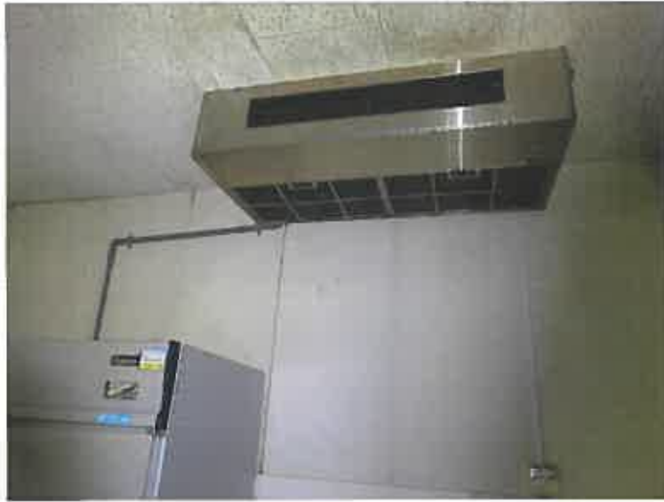
写真４６（本件建物内にある写真１１のエアコン室内機）
