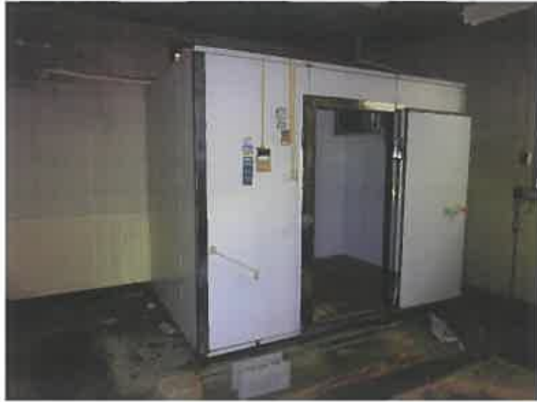
写真 5 2 (本件建物内にある写真 1 7 の冷蔵庫)
