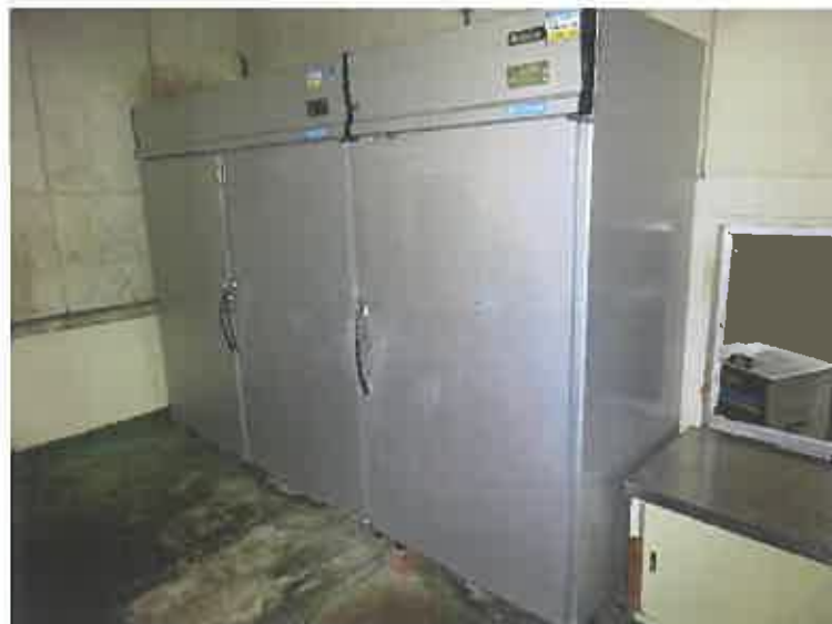
写真４５（本件建物内にある写真１１の冷蔵庫）
