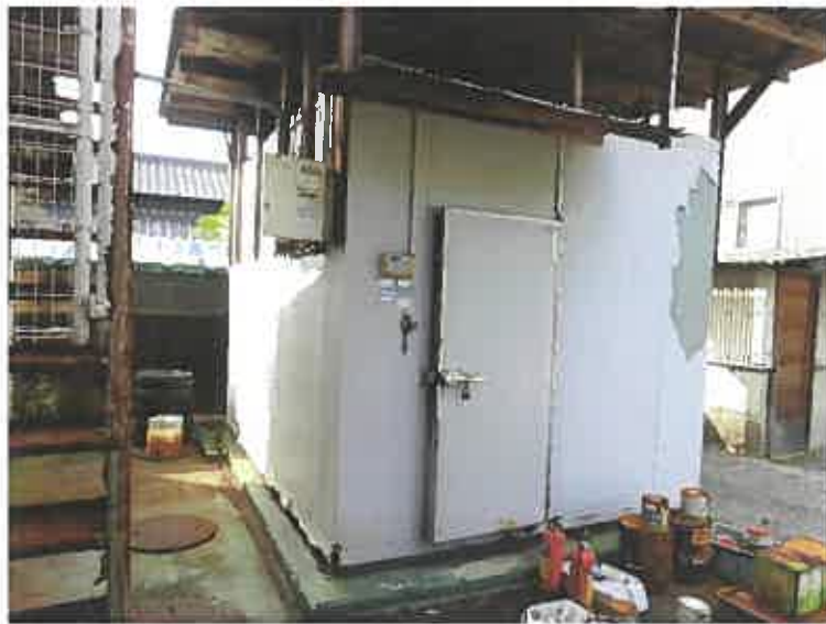
写真41 (本件土地内にある写真6の冷蔵庫)
