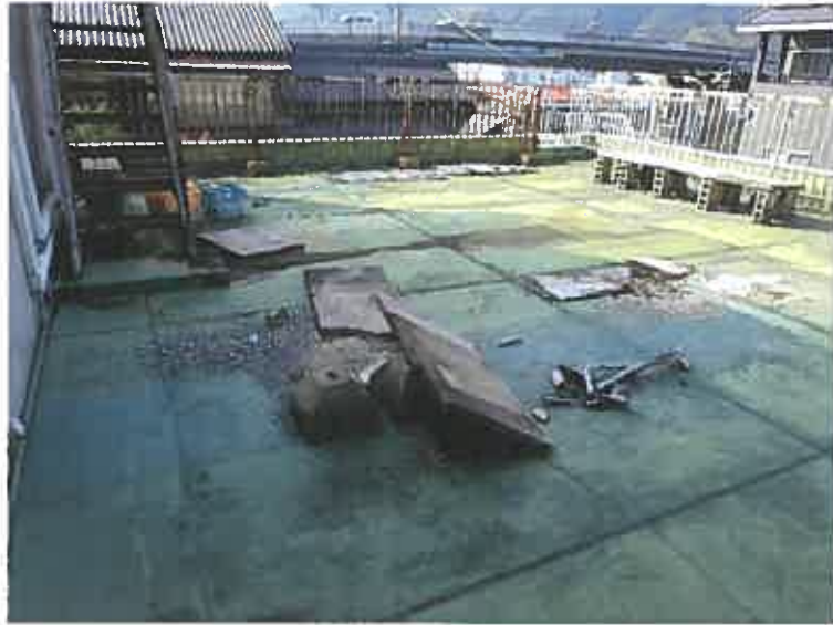
写真 3 7 (本件建物 2階ベランダ)
