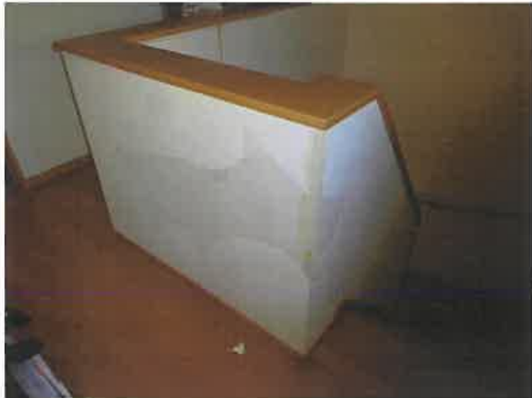
写真1 4 (本件建物 2階 (壁紙が剥がれている状況))
