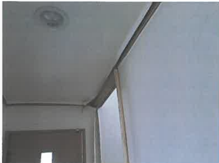
写真15 天井クロスの剥離
