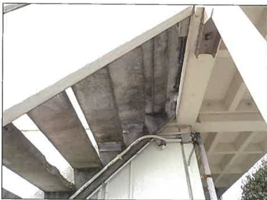
② 外階段のコンクリートの剥落等の状況
