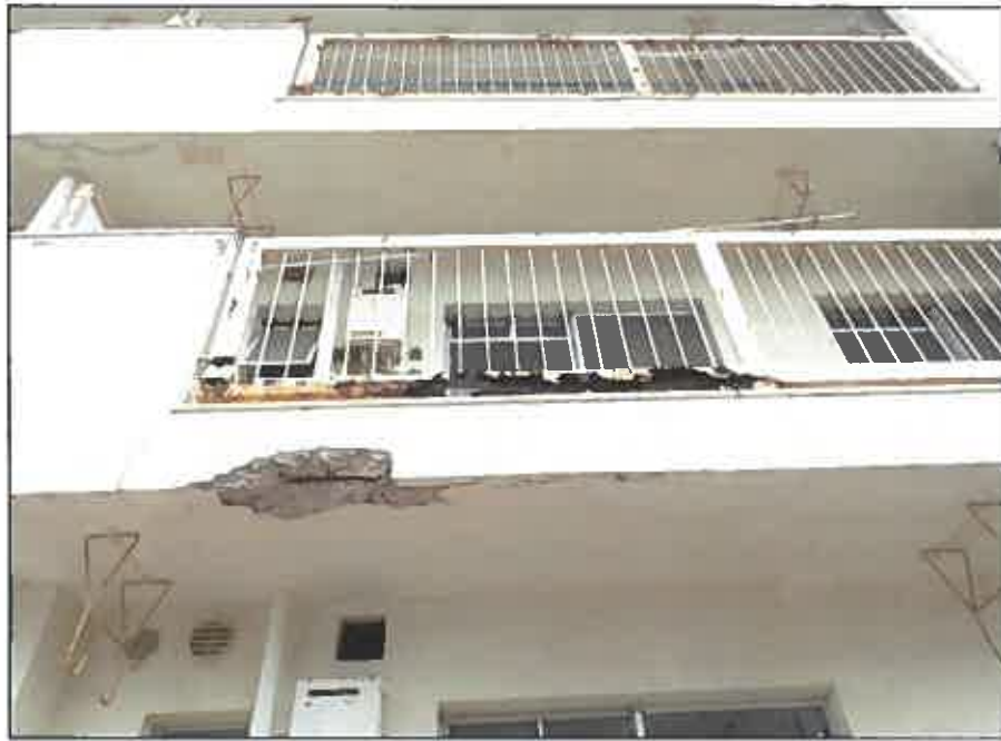
⑩ マンションの外壁・ベランダ等の破損等の状況
