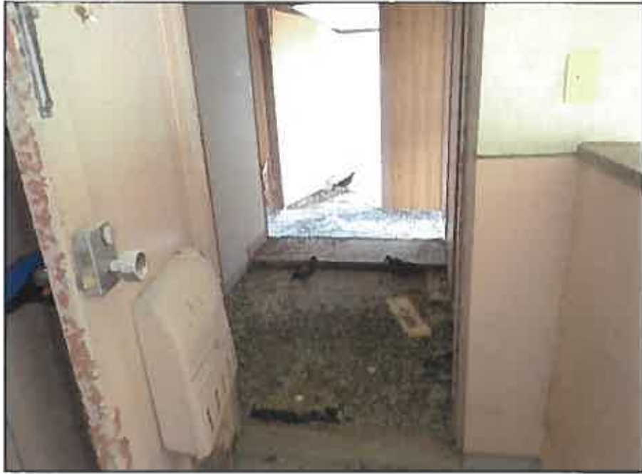
③ 物件5 玄関付近 鳩の被害等の状況
