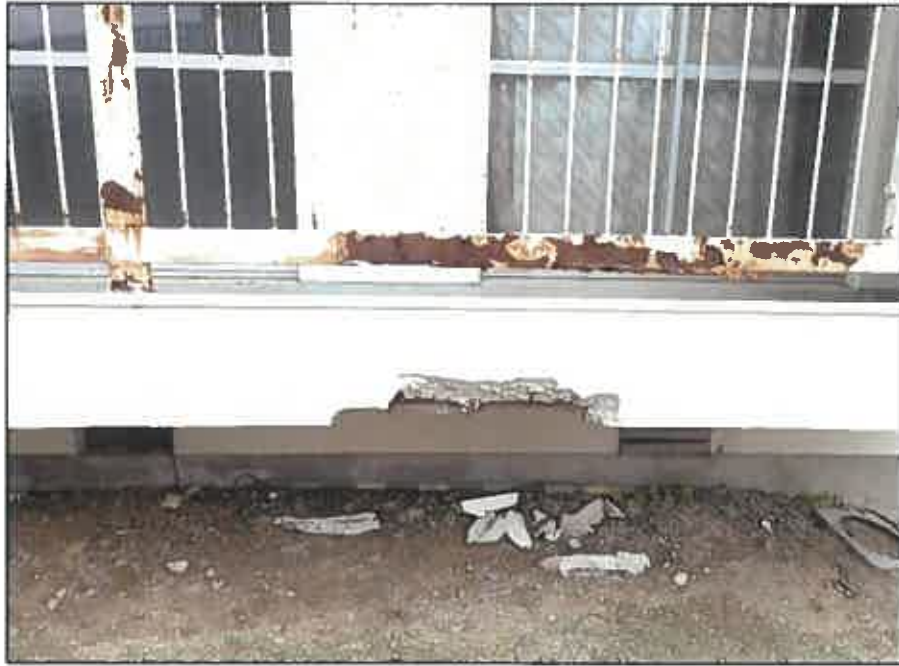
⑨ マンションの外壁の破損等の状況
