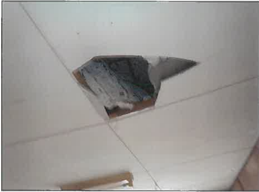
⑤ 物件12 DKの天井の破損等の状況
