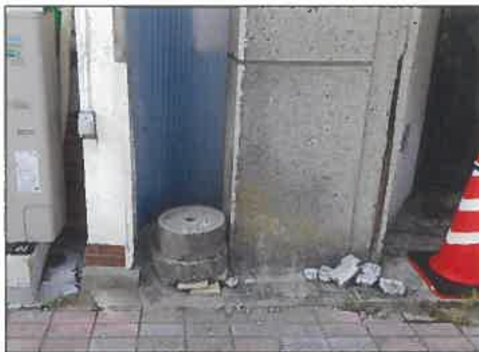
写真2 剥離した外壁の一部が落下した形跡がある状況
