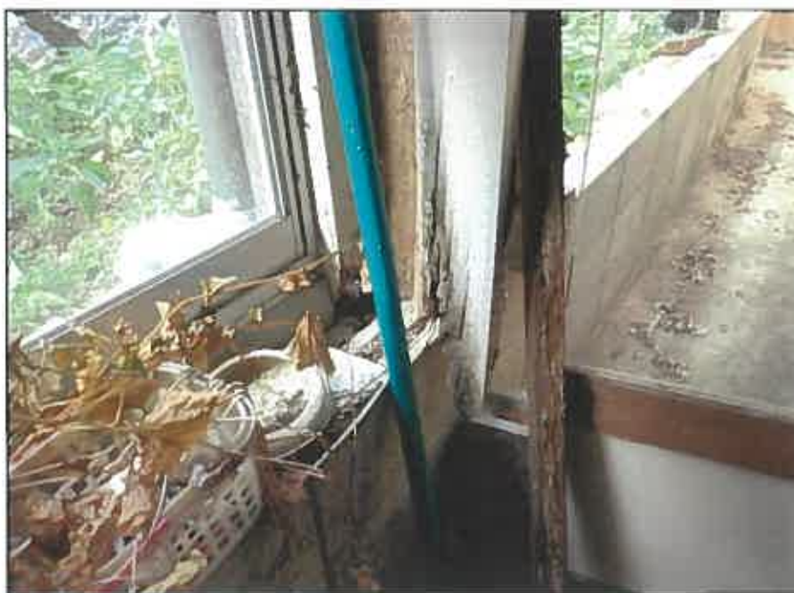
④ 物件4建物の柱等の白蟻被害等の状況
