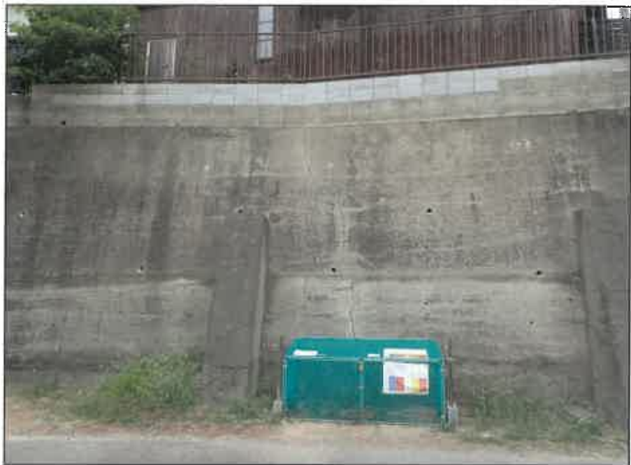
④ コンクリート擁壁のクラック等
