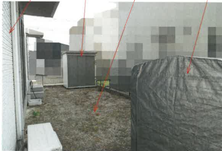
写真4 物件2建物 簡易物置 物件1土地 サイクルハウス
