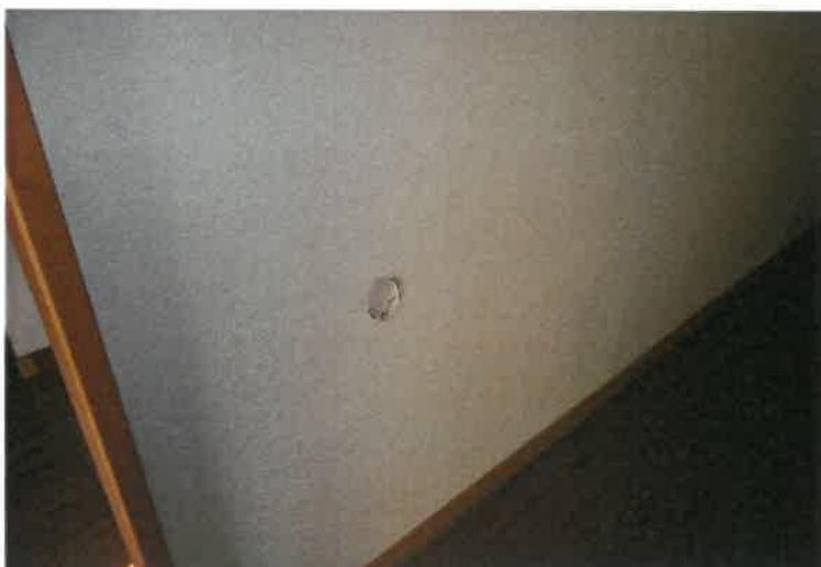
写真1 5 2階階段横廊下側凹み
