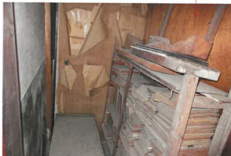
写真1 4 物件2建物・玄関東側物置 不明な箇所
