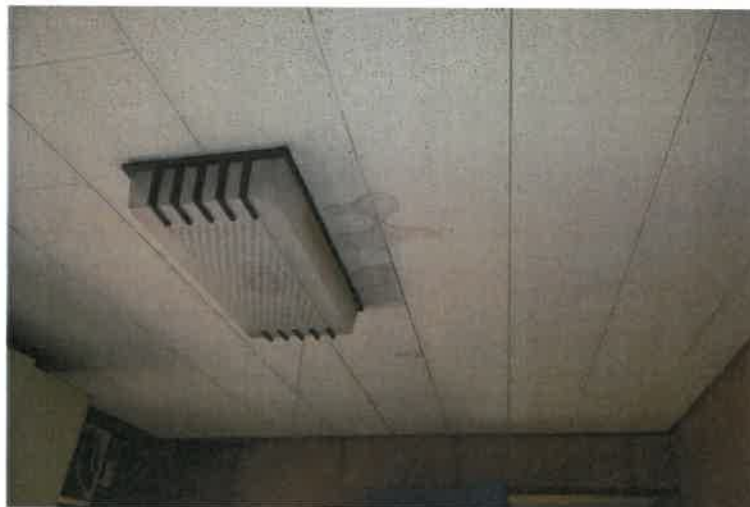
写真29 物件3建物・リビング天井水シミ
