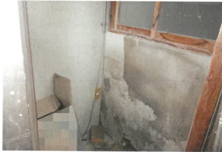
写真 2 2 物件 2 建物・北東側物入（浴室東側）
