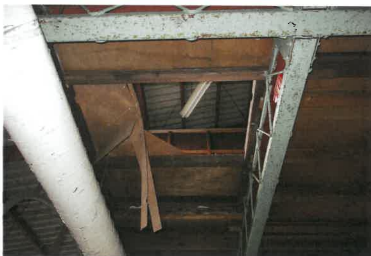
写真1 5 1階天井（穴あき・2階物置部分）
