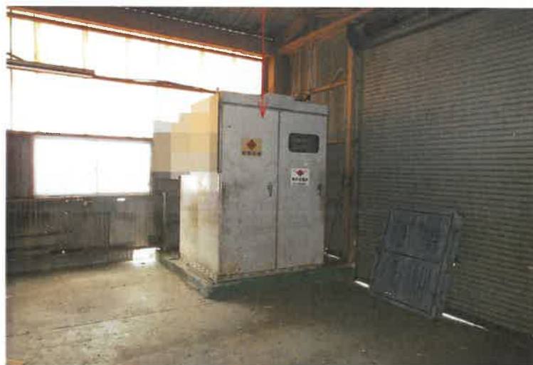
写真10 1階南東側 変電設備
