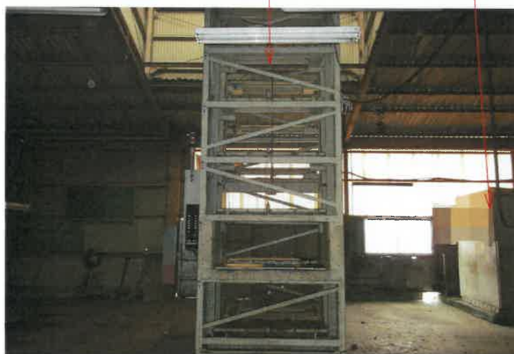
写真11 1階東側 金型保管機 変電設備
