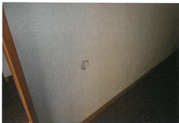
写真 1 5 2 階階段横廊下側凹み
