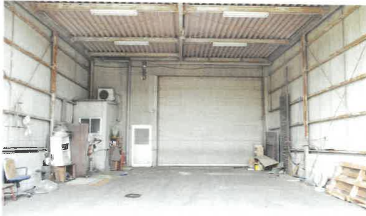
写真10 物件4建物・1階南側未登記増築部分
