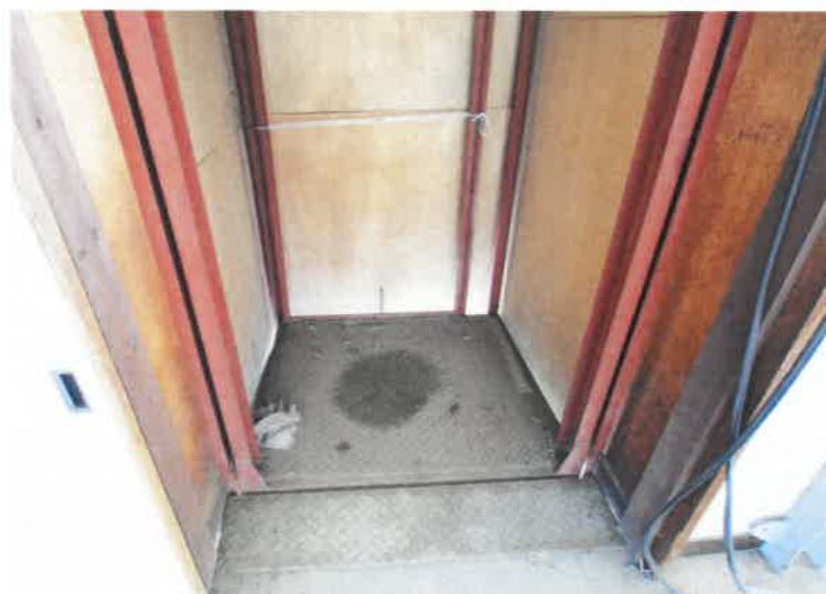
写真1 5 (物件5 符号1 附属建物2 階リフト)
