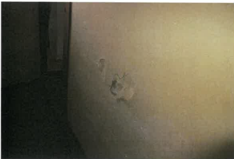
写真21 2階廊下(洋室側壁凹み)
