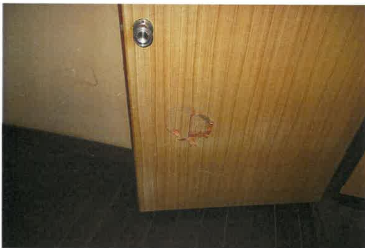
写真20 2階洋室ドア凹み
