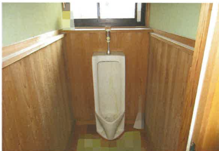
写真8 物件3主建物・1階男子トイレ（使用禁止）
