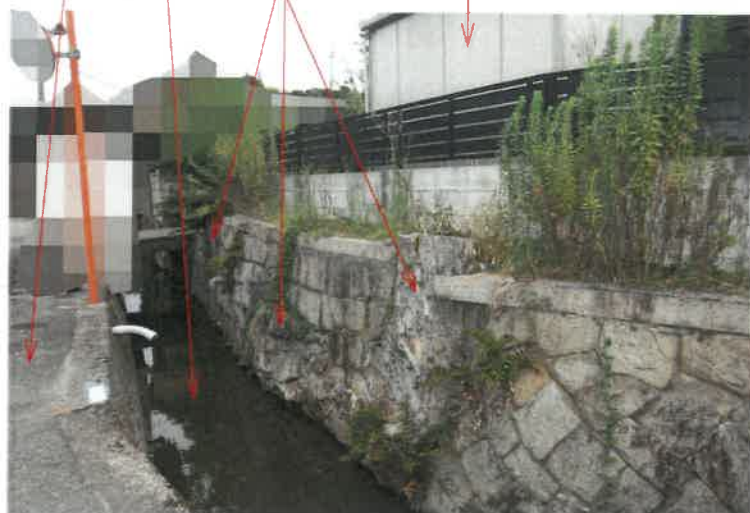
写真4 市道 水路 木の根 簡易物置
