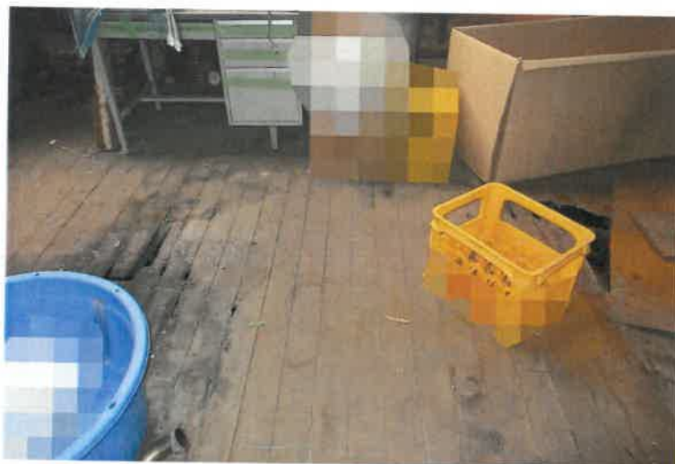
写真 2 5 物件 3 建物・2 階物置（床腐食部分）
