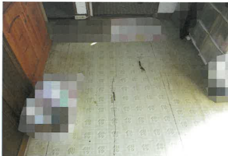
写真40 物件3建物・4号室・1階DK（床面）
