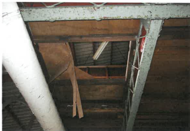
写真1 5 1階天井（穴あき・2階物置部分）
