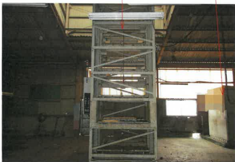
写真11 1階東側 金型保管機 変電設備
