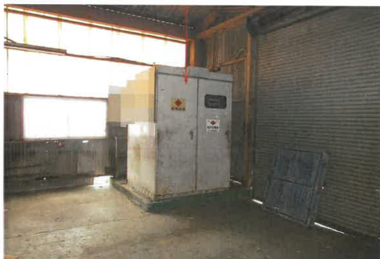
写真10 1階南東側 変電設備
