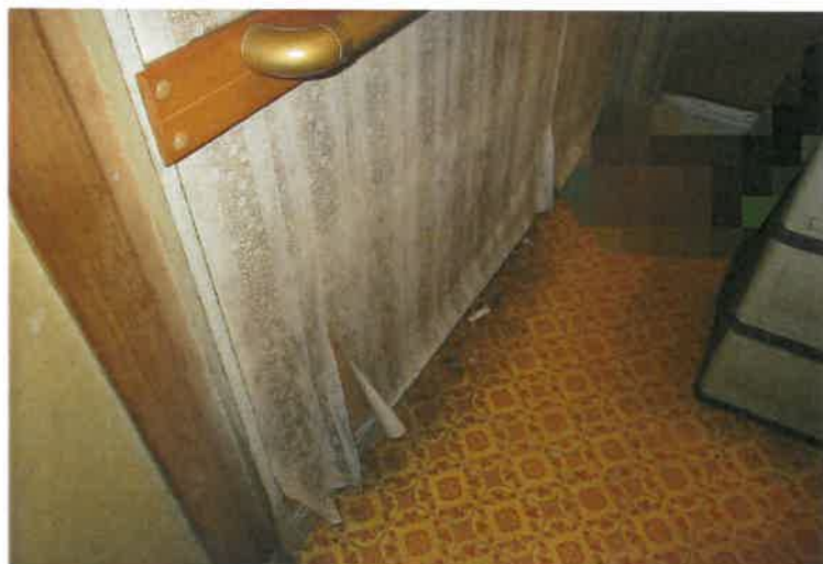
写真12 1階洗面所（壁剥がれ）
