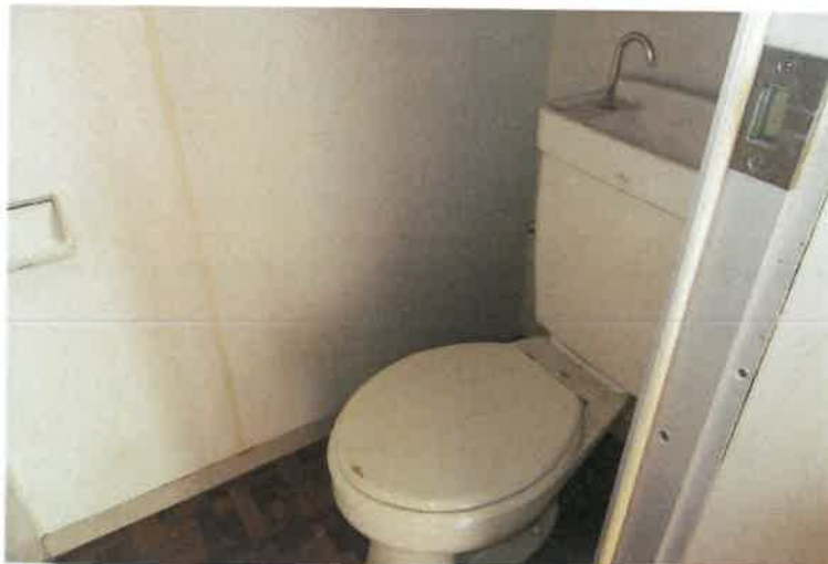
写真 7 3 物件 2 主建物・4 階洗濯室横トイレ
