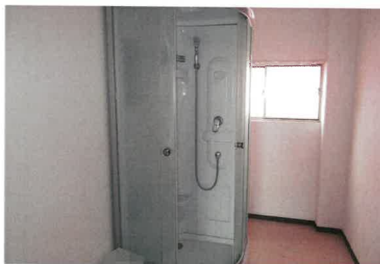
写真120 物件4建物・3階シャワー室
