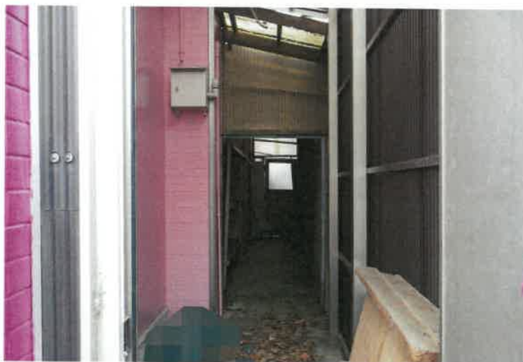
写真 9 8 物件 4 建物・1 階物置（未登記増築部分約 1 2 平方メートル）
