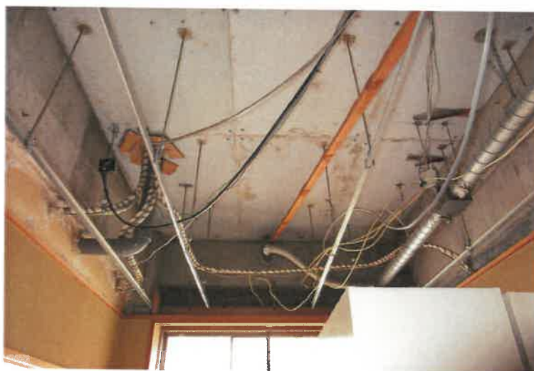
写真7 1 物件2主建物・4階寮室2天井部分
