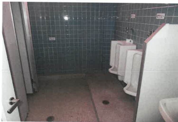
写真 1 1 2 物件 4 建物・2 階トイレ
