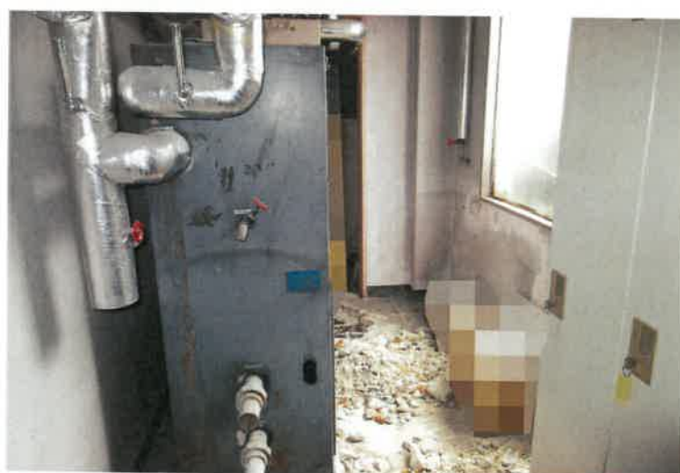
写真 9 2 物件 4 建物・1 階機械室 1
