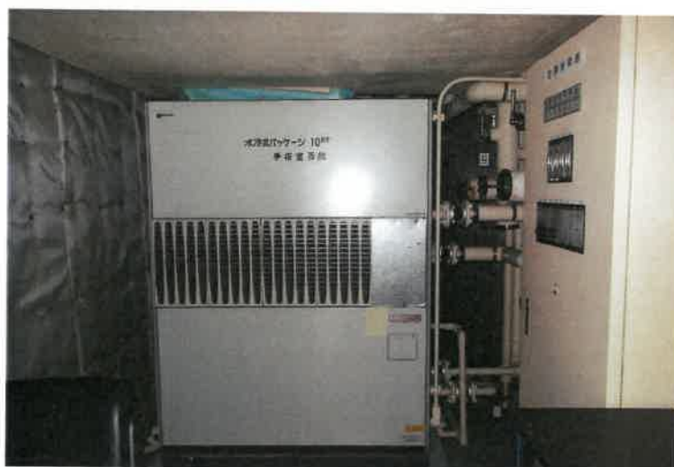
写真 7 4 物件 2 主建物・4 階機械室
