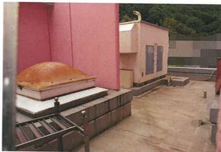
写真5 3 物件2主建物・3階機械室
