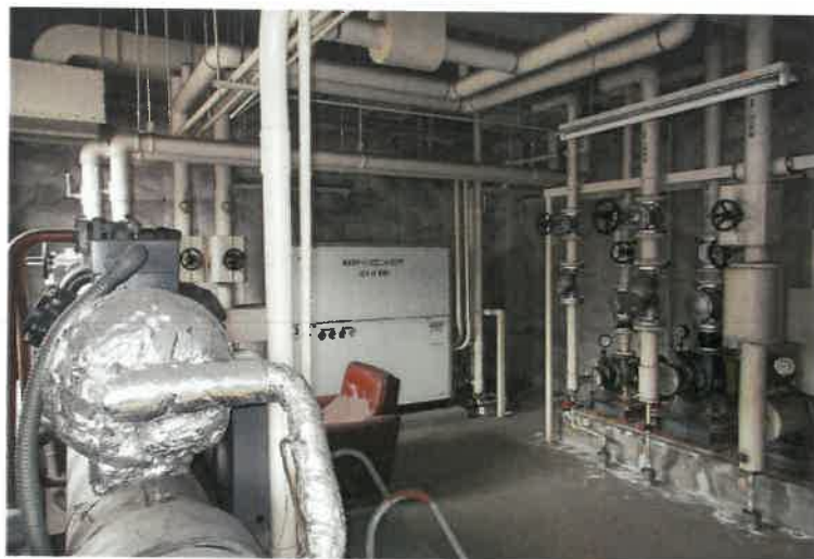
写真 4 0 物件 2 主建物・2 階機械室
