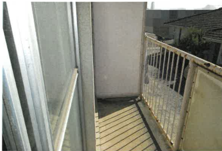
写真35 物件3建物・3号室・2階バルコニー
