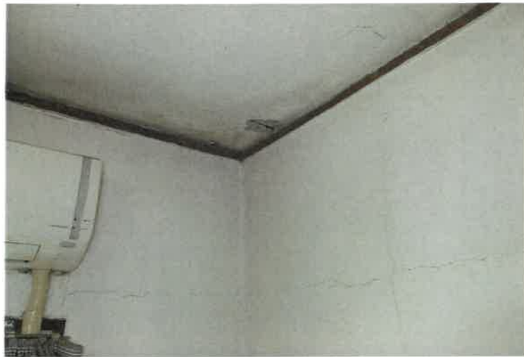
写真14 物件3建物・1号室・1階和室4.5帖天井（雨漏り箇所）
