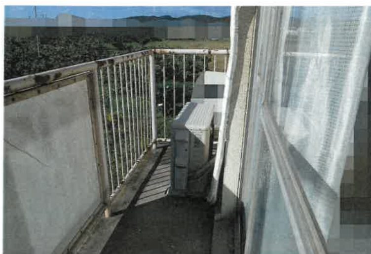
写真4 4 物件3建物・4号室・2階バルコニー
