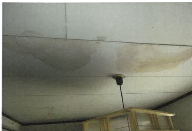
写真17 物件3建物・1号室・2階和室6帖天井（雨漏り箇所）
