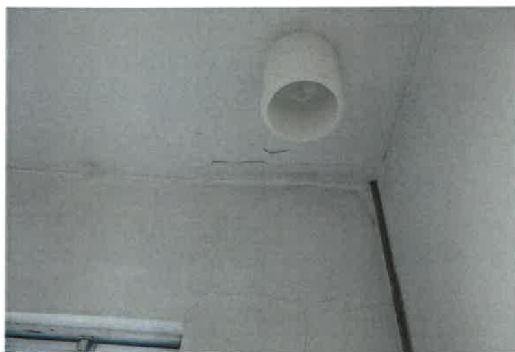
写真9 物件3建物・1号室・1階トイレ天井（ひび割れ）
