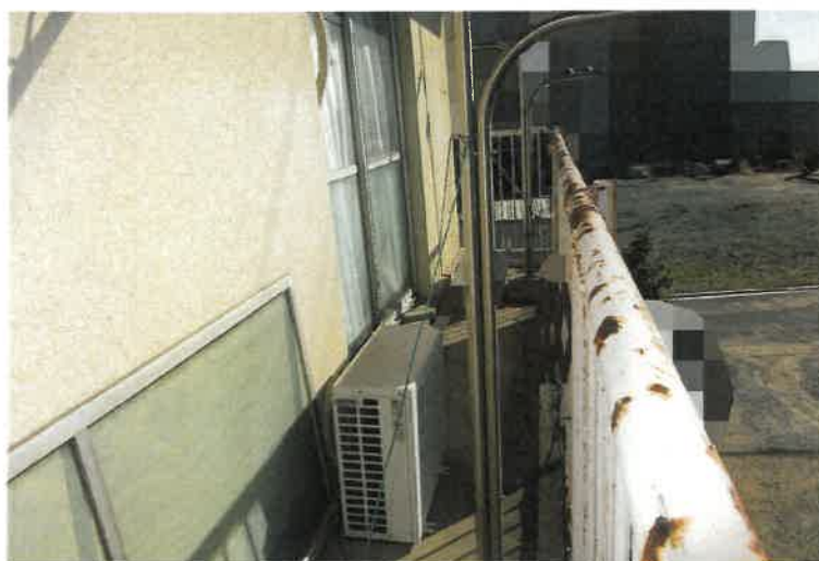
写真18 物件3建物・1号室・2階バルコニー
