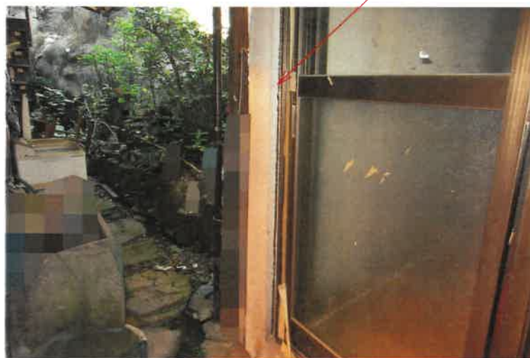
写真27 物件7建物・1階DK側壁ひび割れ部分
