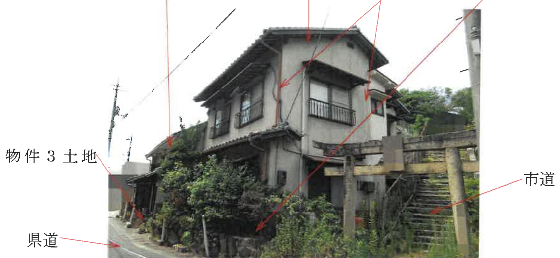
写真1 物件6 附属建物符号1 物件7 建物 ひび割れ 物件5 土地
