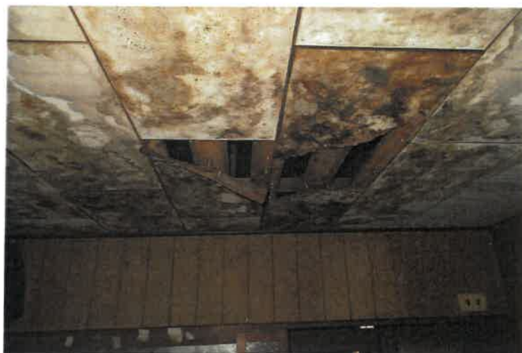
写真19 物件6附属建物符号1・1階洋室（天井剥がれ）
