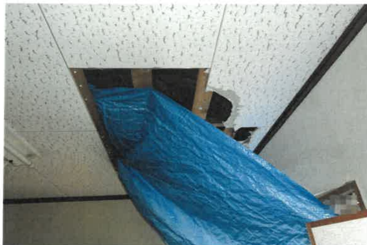
写真40 2階洋室①天井の雨漏りの状況
