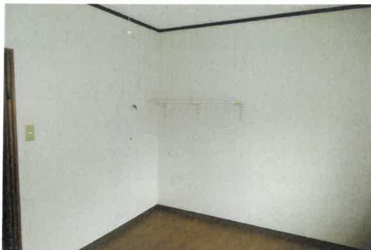
写真3 1 物件4建物・2階北側洋室（穴あき）
