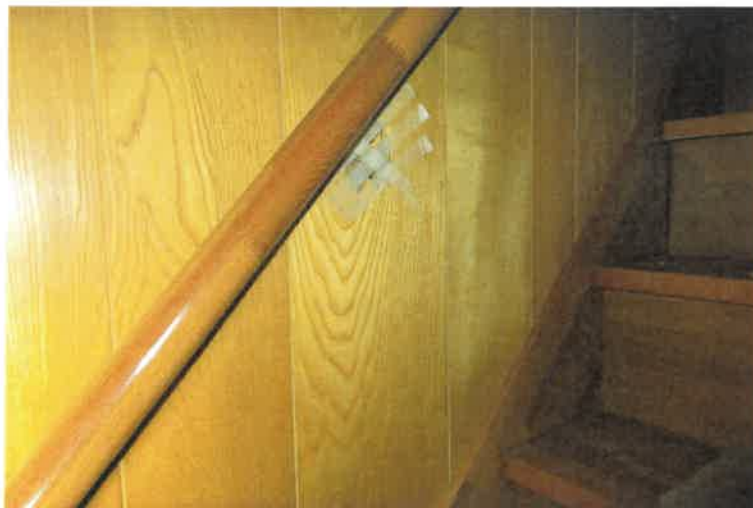
写真28 物件4建物・1階階段部分（穴あき）
