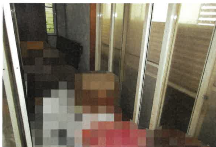
写真12 1階縁（未登記増築部分）
