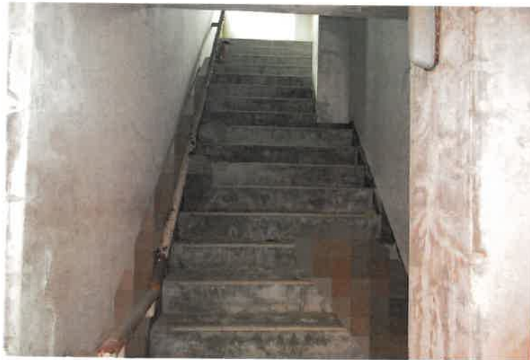
写真 9 7 物件 4 建物・1 階倉庫 4 北西側階段部分
