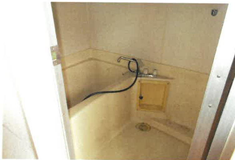
写真 7 6 物件 2 主建物・4 階更衣室西側浴室
