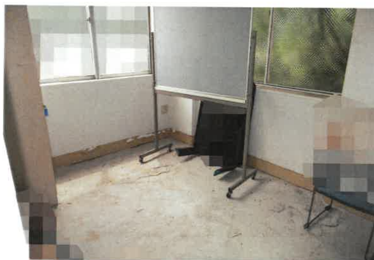
写真 1 1 7 物件 4 建物・3 階休憩室 3（床板なし）
