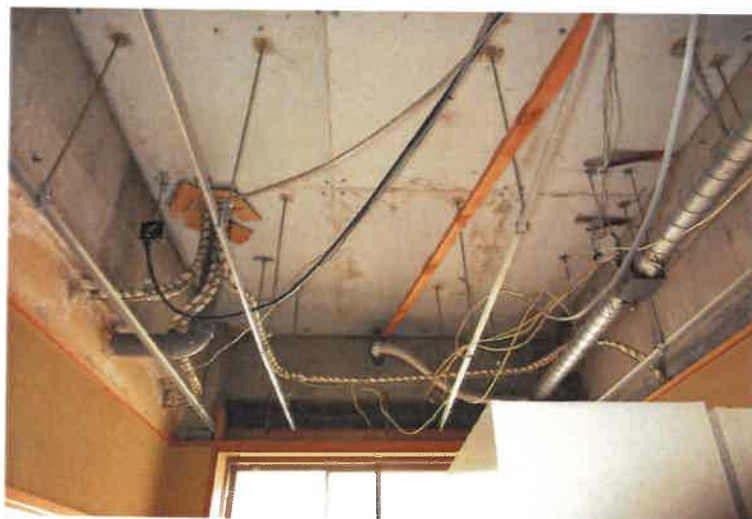
写真 7 1 物件 2 主建物・4 階寮室 2 天井部分
