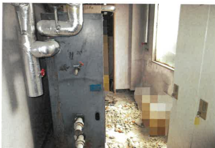
写真 9 2 物件 4 建物・1 階機械室 1
