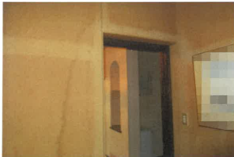
写真1 3 物件3建物・1階洋室（雨シミ）
