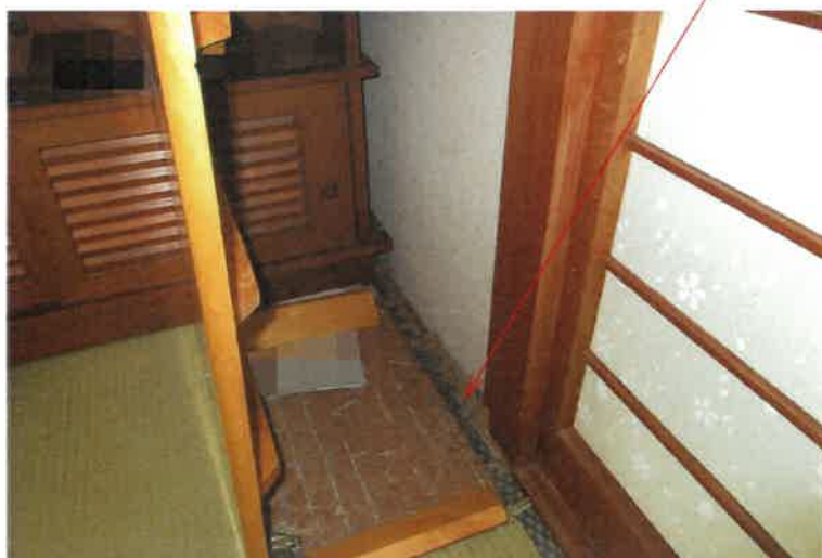
写真1 5 物件3建物・1階和室8帖・シロアリがきている部分
