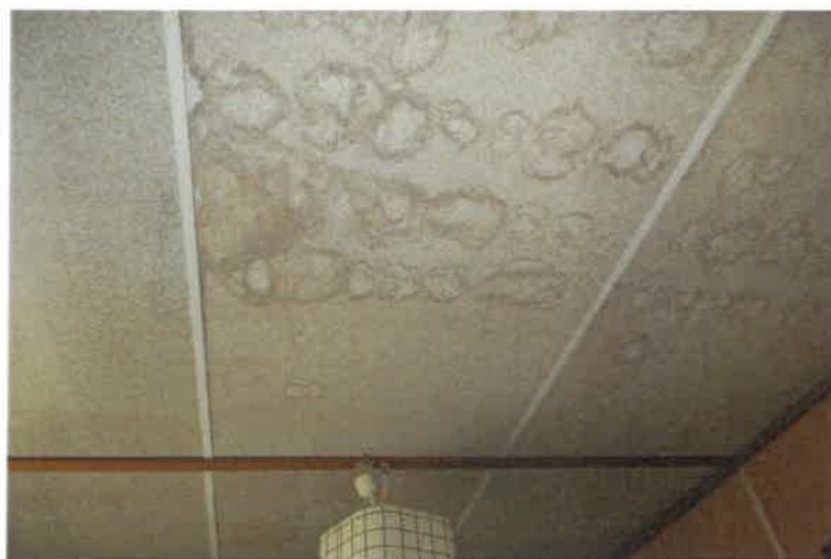
写真 2 2 物件 3 建物（未登記附属建物）・洋室（天井雨シミ）
