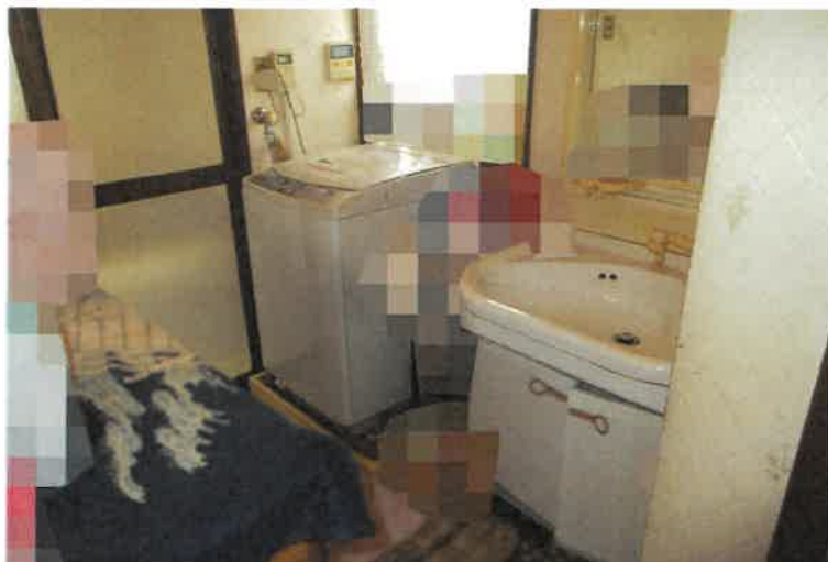
写真8 物件3建物・1階洗面所
