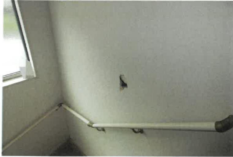
写真13 2階階段側壁（穴あき）
